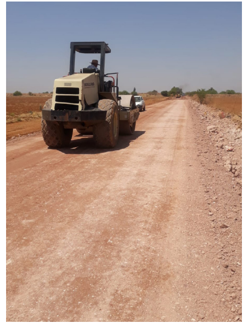
Construcción de terracería en la localidad Llano Blanco Norte, carretera Pozo de Gamboa-Llano Blanco Norte (2 mil 135 m2)
